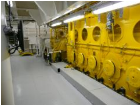
een der dieselmotoren
